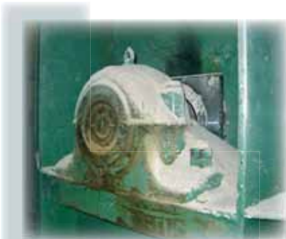
Capa de polvo excesiva sobre rodamiento.
