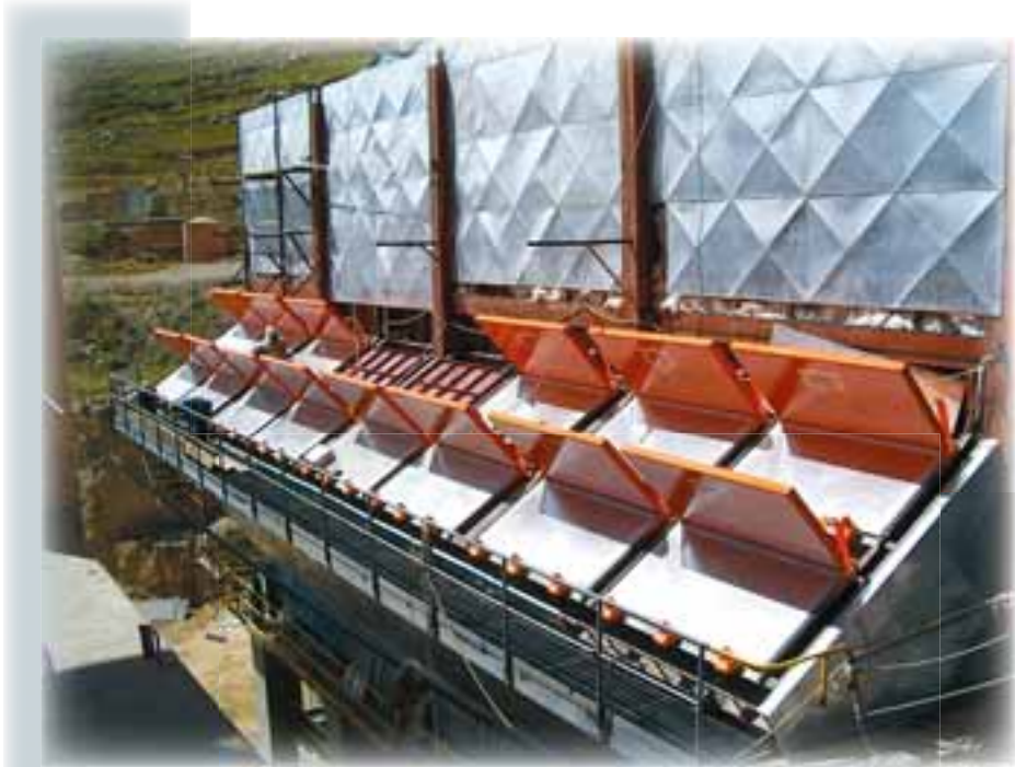
Filtro de mangas protegido con puertas de venteo de explosiones.
