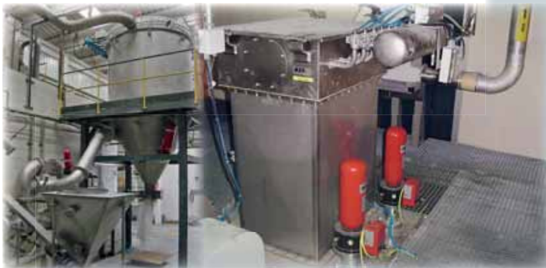
Instalación protegida mediante supresión de explosiones.
